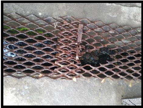
Kondisi drainase di dapur PT.Chitose Internasional Tbk
