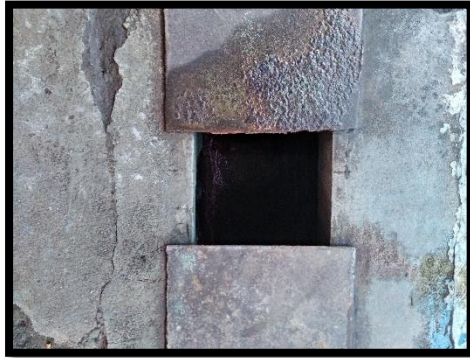
Kondisi drainase di dapur PT.Chitose Internasional Tbk
