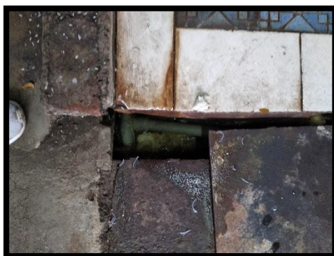
Kondisi drainase di dapur PT.Chitose Internasional Tbk
